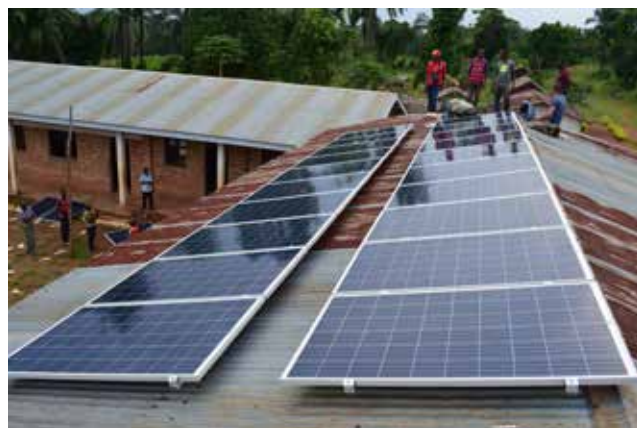
L'impianto fotovoltaico della Scuola Pedrollo
